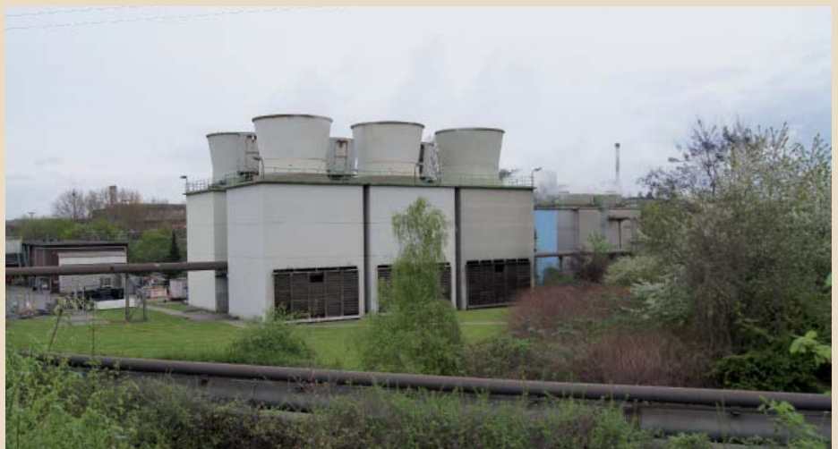
Kühltürme, Verdunstungskühlanlagen und Nassabscheider stehen im Fokus der 42. BImSchV
